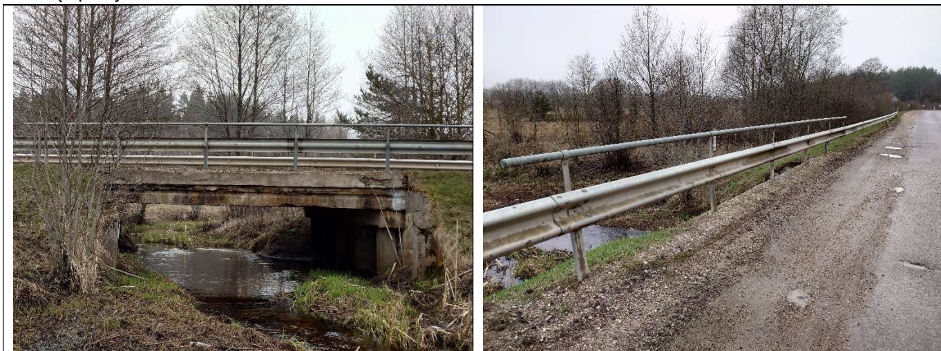
Neįrengti šalintilčiai, vanduo bėgdamas per fasadinę dalį ardo perdangos plokštes ir atramų elementus.
